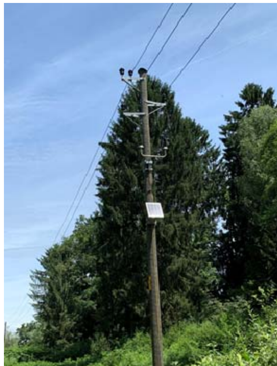
Slika 7: ALiSa sa solarnim napajanjem na DV 10 kV-Ljubljana Barje
